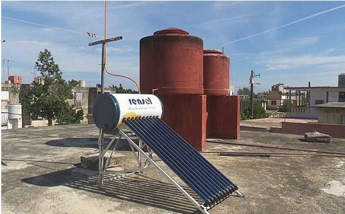
Fig.18. Instalación de calentadores solares por la industria nacional, en contribución de la Tarea 8. Foto: Tomada de Cubadebate.
