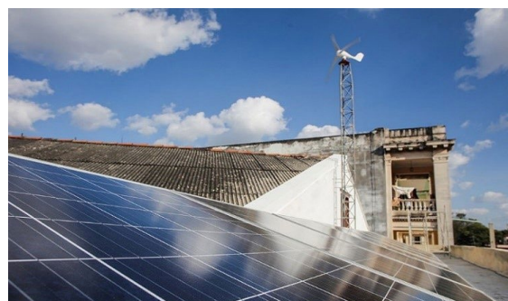
Fig.17. Contribución a la Tarea 8. Imagen de la azotea de las instalaciones de Estudio 50, estudio fotográfico de la Habana, entidad no estatal que incorporó fuentes renovables de energía logrando independencia energética de la red nacional y autosustentabilidad. Tomado de: Vistar Magazine
